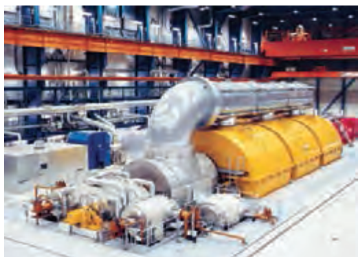
شکل ۲- ژنراتور سه فاز در نیروگاه
