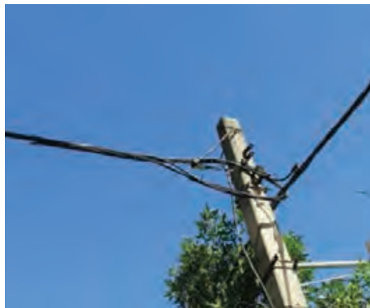
شکل ۲- کابل خود نگهدار
