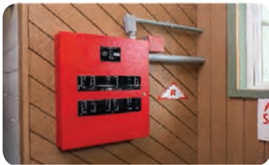
شکل ۳-۴۹- تصویر تابلو کنترل
