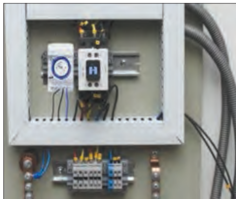
شکل ۱۰۷- محل نصب تایمر ۲۴ ساعت در تابلو روشنایی
