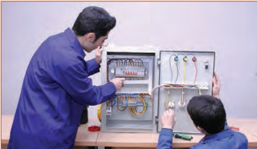
شکل ۳۰- قطعات الکتریکی و غیر الکتریکی تابلو برق
