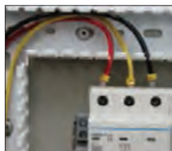
نصب غلط شماره سیم
