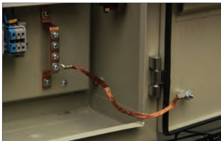
شکل ۹۲- صفحه نصب در داخل تابلو
