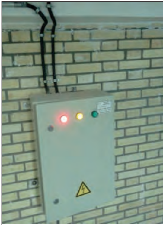
شکل ۲۰- مسیر ورود و خروج کابل‌ها در تابلو
