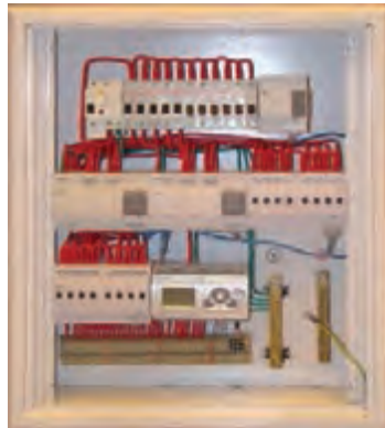
شکل ۵۳- دو نمونه تابلوی توزیع برق (DP)
