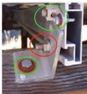
شکل ۵۶- پیچ متصل به سازه فرسوده شده است
