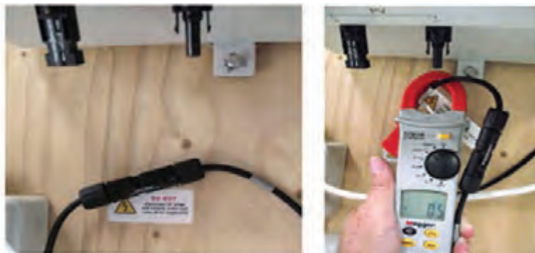
شکل ۹- اندازه‌گیری جریان اتصال کوتاه با آمپر متر انبری
