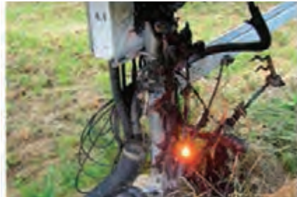
شکل ۳۶- سامانه فتوولتاییک بدون اتصال زمین که منجر به آتش سوزی شده است.
