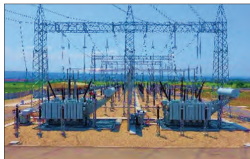
شکل ۳- پست تقویت ولتاژ
