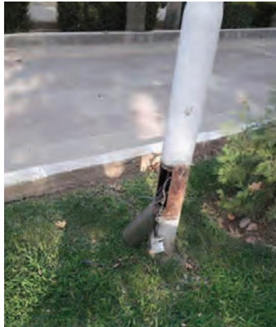
شکل ۲- وجود خرابی در سیستم برق کشی
