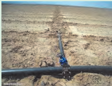
شکل ۴۶-۵. شیر فلکه لوله جانبی
