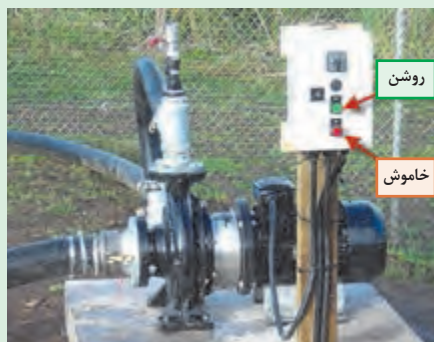
شکل ۲۸-۵. کلیدهای کنترل روی تابلو
