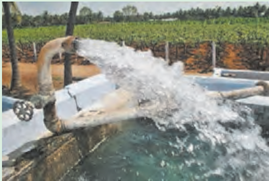
شکل ۳۰-۵. لوله برگشت آب
