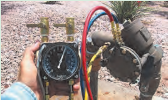
شکل ۳۱-۵. تنظیم فشار شیر فشار شکن
