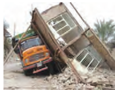
الف) ریزش دیوار در اثر زلزله
