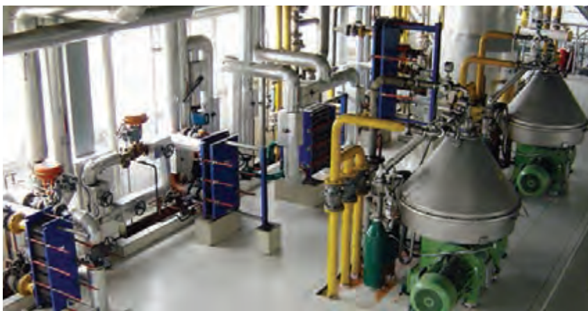
شکل ۶- سیستم خنثی‌سازی مداوم روغن
