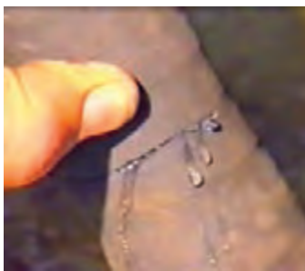
شکل ۶. نشتی از شیلنگ ها
