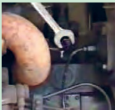
شکل ۲۹. شل کردن مهره لوله پر فشار انژکتور
