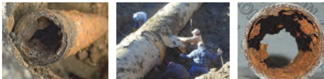
شکل ۴- نمونه‌ای از خوردگی لوله‌های دفن شده
