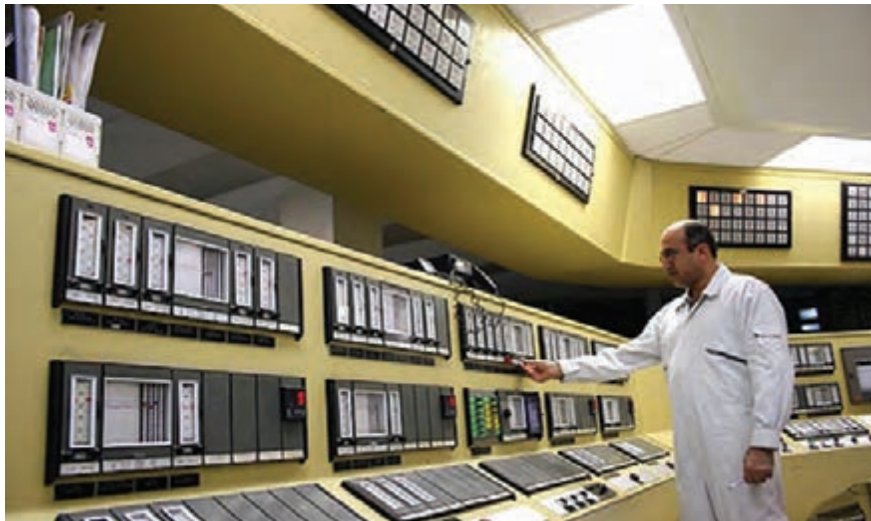
شکل ۳۴- اتاق فرمان موجود در پالایشگاه گاز
