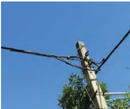
شکل ۲- کابل خود نگهدار
