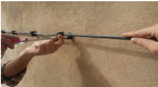
شکل ۳۷- کابل نصب شده روی دیوار
