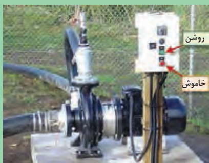
شکل ۱۴- کلیدهای کنترل روی تابلو
