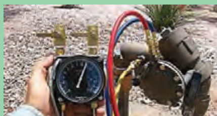
شکل ۱۷- تنظیم فشار شیر فشارشکن
