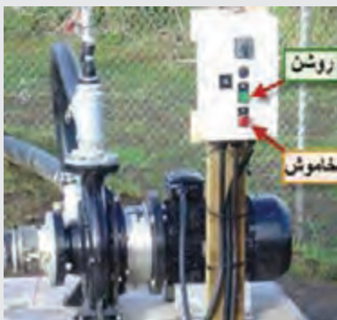
شکل ۲۰- کلیدهای کنترل روی تابلو
