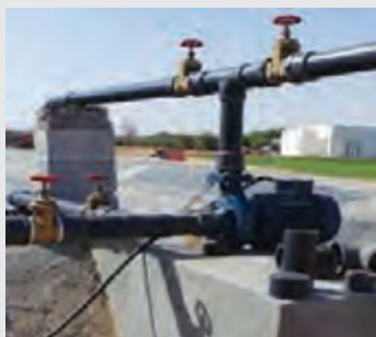
شکل ۱۸- شیرفلکه لوله رانش
