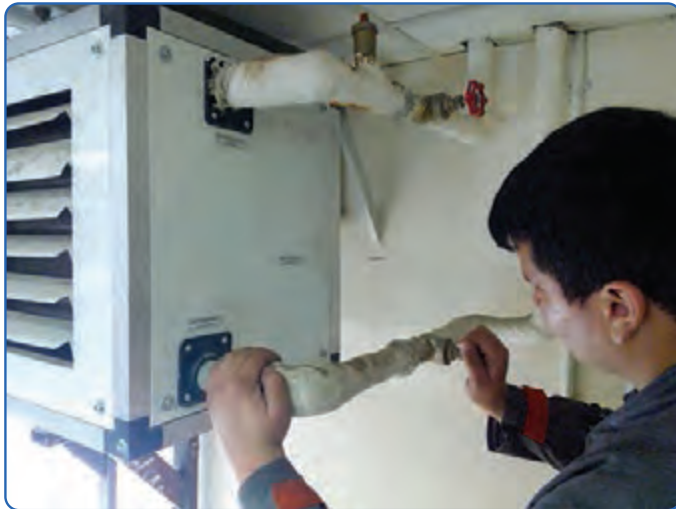
شکل ۱۵- کنترل شیرهای رفت و برگشت و شیر هواگیری یونیت هیتر آب گرم
