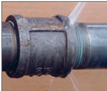
شکل ۱۱- یک اتصال در حال نشتی
