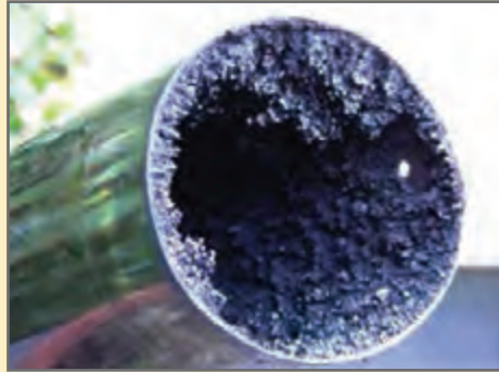
دوده ایجاد شده در داخل لوله
