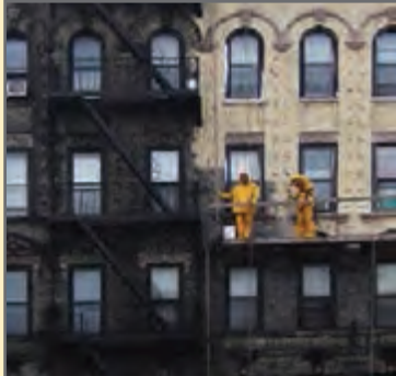
دوده زدایی بر روی نمای ساختمان
