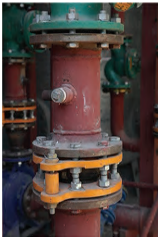
شکل ۲۰- ارتعاش گیر روی پمپ
