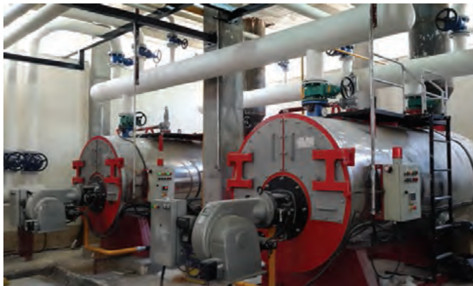
شکل ۲- نمایی از یک موتورخانه
