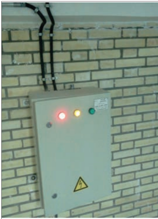
شکل ۲۰- مسیر ورود و خروج کابل‌ها در تابلو
