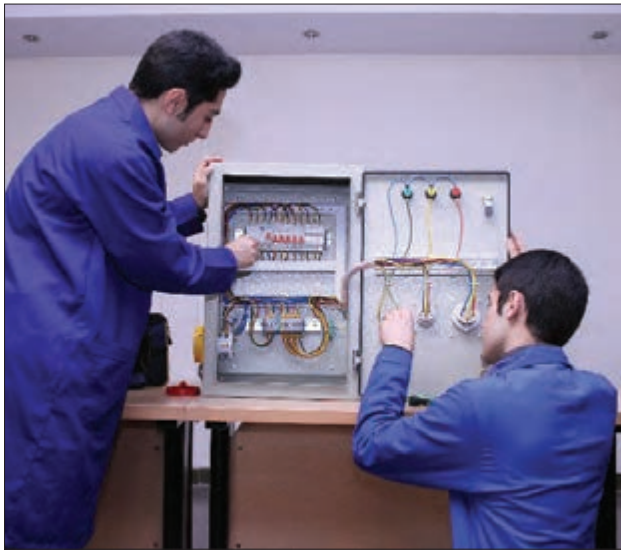
شکل ۲- تابلو برق فشار ضعیف
