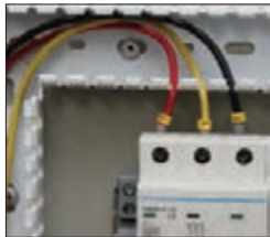
نصب غلط شماره سیم
