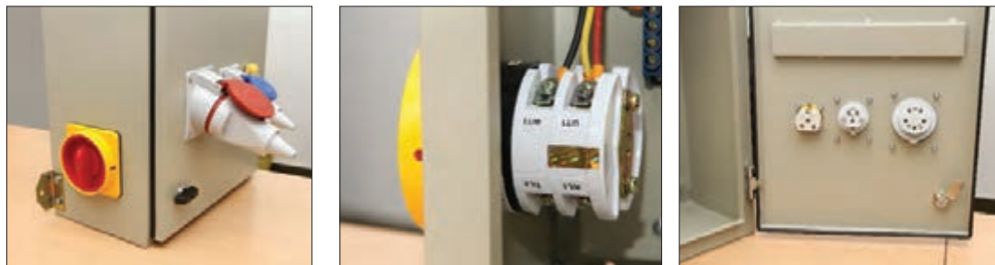
ب) نمای کلید گردان و پریزهای نصب شده روی بدنه تابلو
