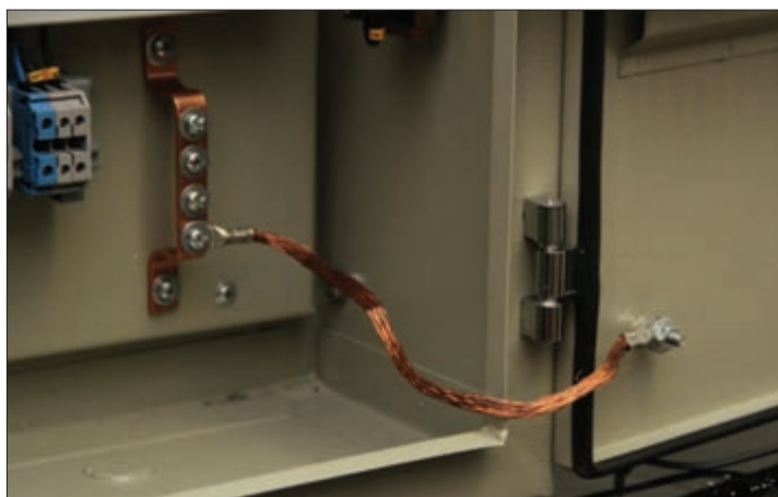
شکل ۹۲- صفحه نصب در داخل تابلو
