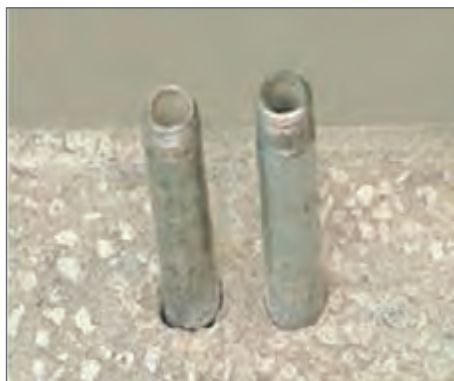
شکل لوله رفت و برگشت در کف
