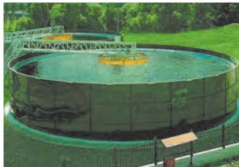
شکل ۱۳-۴- مخزن ذخیره‌سازی بدون سقف
