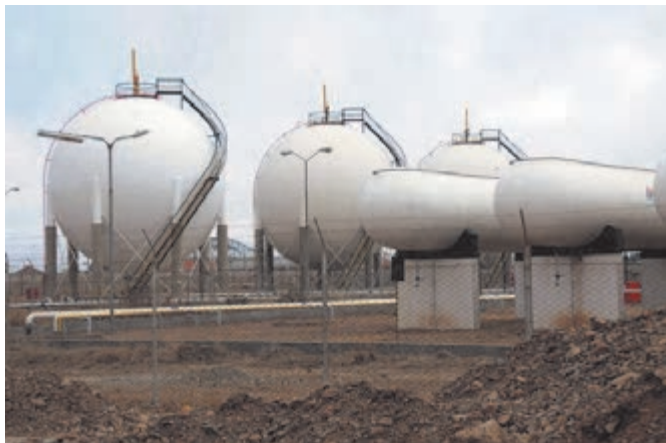
شکل ۴-۱۵ مخازن تحت فشار
