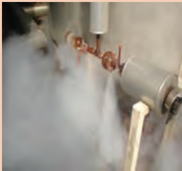
نشستی از اتصال در خط لوله
