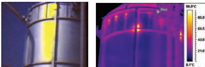
شکل ۱۳- تشخیص نشتی حرارتی از عایق مخازن
