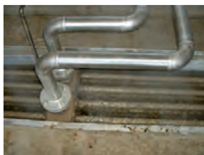
شکل ۶۱- کویل‌های حرارتی برای گرم کردن هوای کوره
