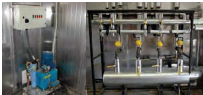
شکل ۶۰- شیرهای کنترل بخارزنی
