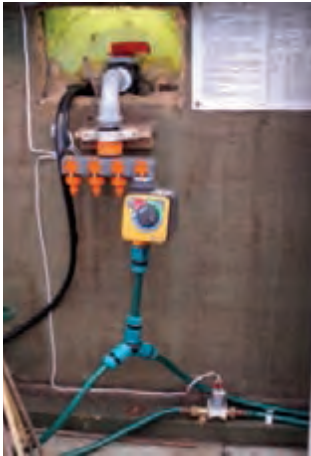
بخشی از سیستم آبیاری اتوماتیک
