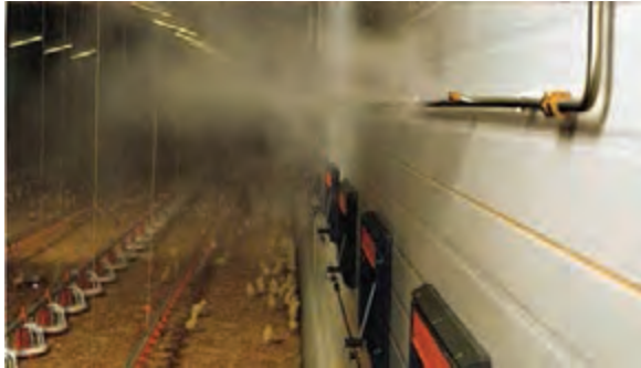
۲ تأمین رطوبت سالن از طریق نازل‌های تحت فشار
