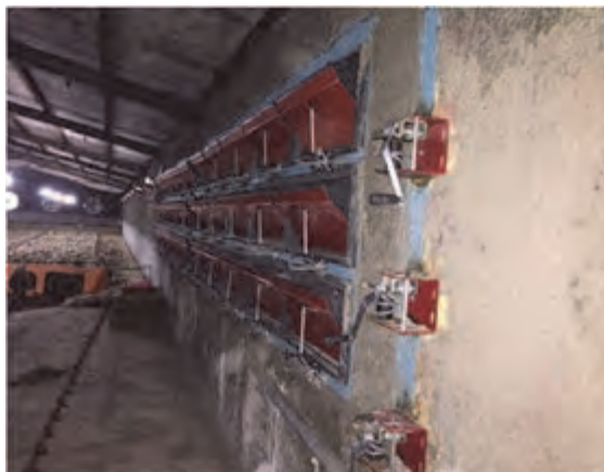
ورود هوا از طریق پنجره‌های خودکار (اینلت)
