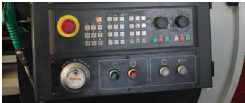
شکل ۱۶- قسمت اپراتوری سیستم کنترل
