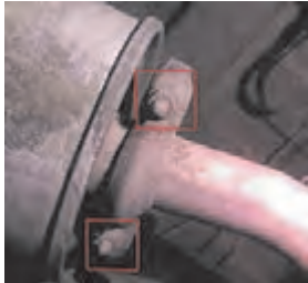
کنترل اتصالات لوله از صدا خفه کن
