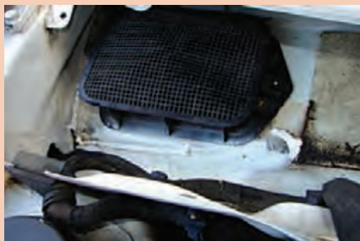
شکل ۲۰- اثر گرفتگی مجرا و عدم تخلیه آب
