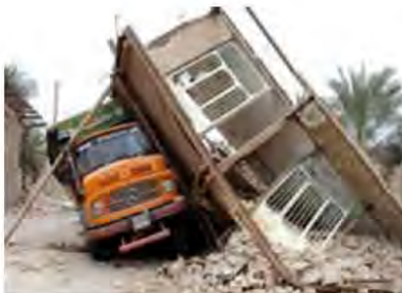
د) ریزش دیوار در اثر زلزله
