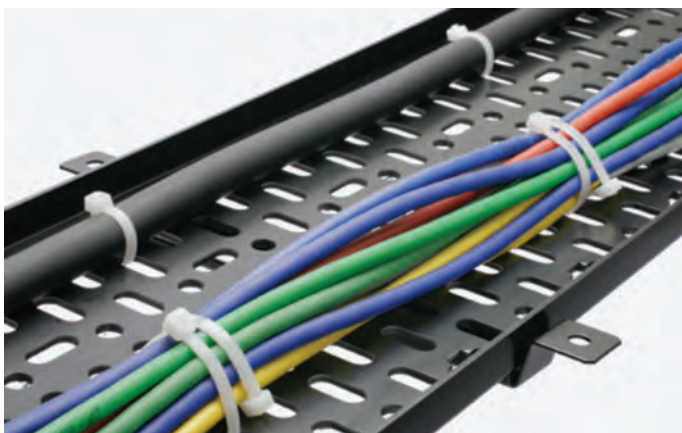
شکل ۲- سینی کابل کشی
