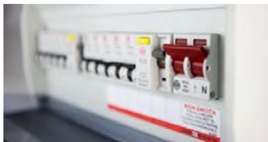
شکل ۷۹- تابلوی توزیع برق واحد مسکونی
