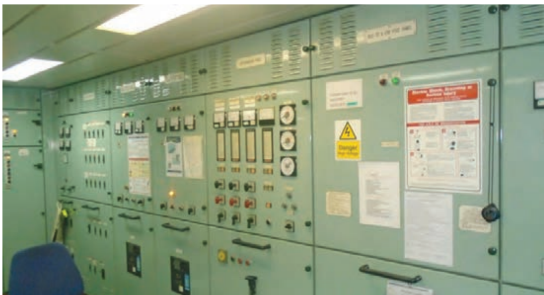
شکل ۲۳- تابلوی اصلی برق شناور
