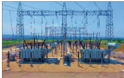
شکل ۳- پست تقویت ولتاژ
