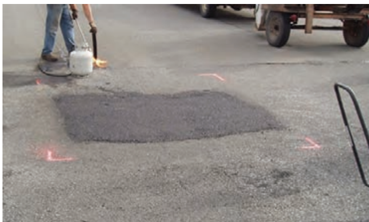
شکل ۳۹- نحوه مشخص کردن محدوده خرابی برای لکه‌گیری
