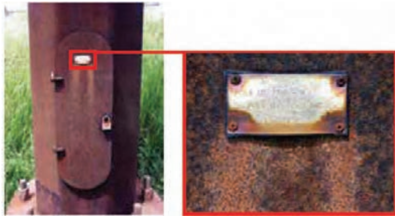
شکل ۵- تشکیل پیل گالوانیک به دلیل نصب پلاک و قفل از جنس آلایژ مس روی ستون فولاد کربنی
