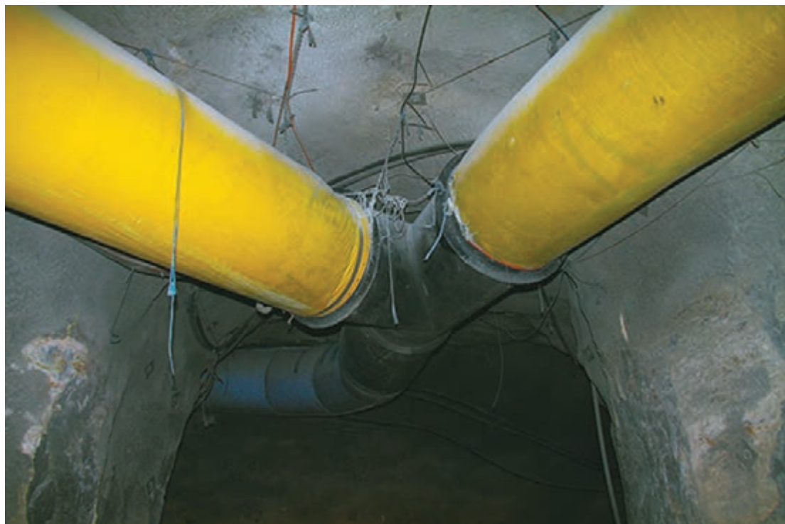
کانال‌های فلزی و برزنتی انتقال هوای معدن
