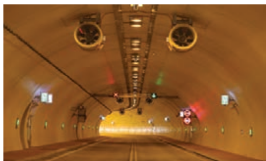
شکل ۱۸- تهویه‌های هوای نصب شده در تونل
