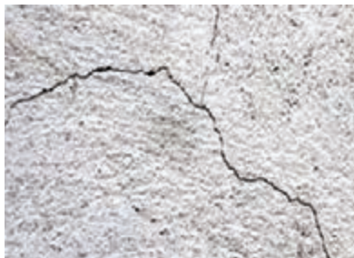
ترک خوردگی انقباضی بتن
