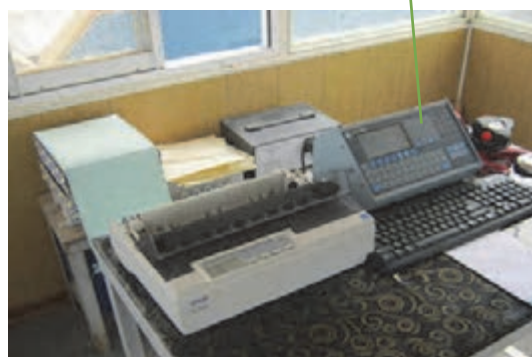
اتاقک کنترل باسکول
