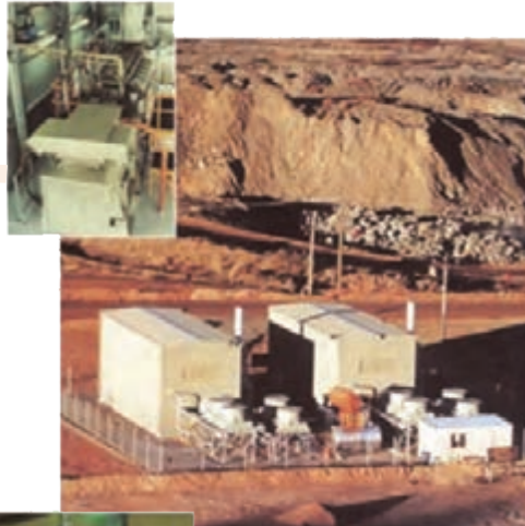
نیروگاه دو واحدی برق در کنار معدنی در استرالیا
