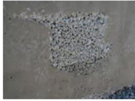
افزایش فضای خالی بتن در اثر وایبره نکردن
